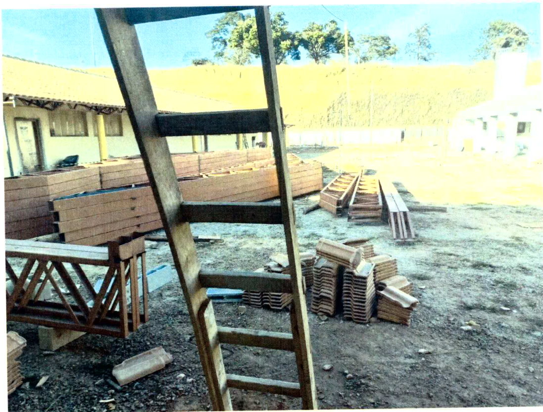
FOTO 04 - PÁTIO - ÁREA SEM COBERTURA
