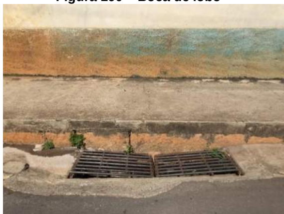
Figura 192 – Boca de lobo
