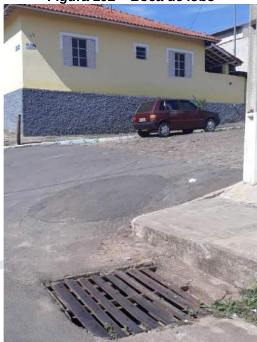
Figura 194 – Boca de lobo
