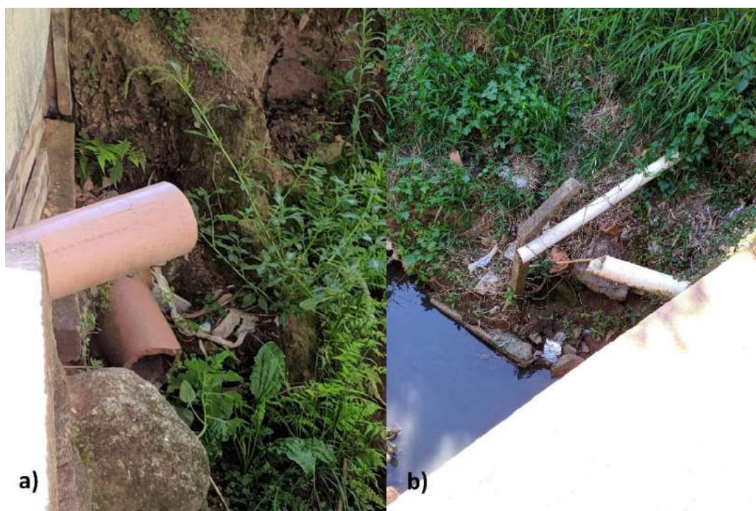
Figura 197 – Ligações clandestinas no Córrego do Mosquito no ponto da “Canalização 4”. a) De um lado da ponte; b) Do outro lado da ponte
