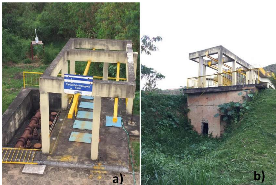
Figura 102 – EEE 8. a) Vista frontal da EEE8, b) Vista da parte de trás da EEE8 com foco na janela de acesso para limpeza do poço de sucção.
