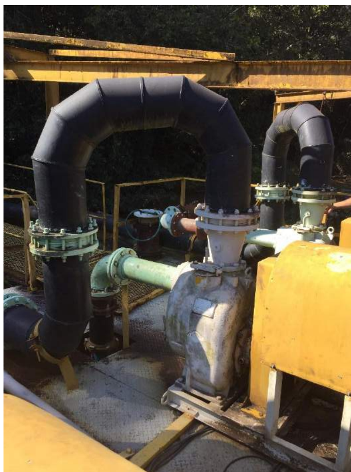
Figura 72 - EEAB - Baixo Recalque: conjuntos moto-bomba em funcionamento Fonte: Próprios autores, 2019
