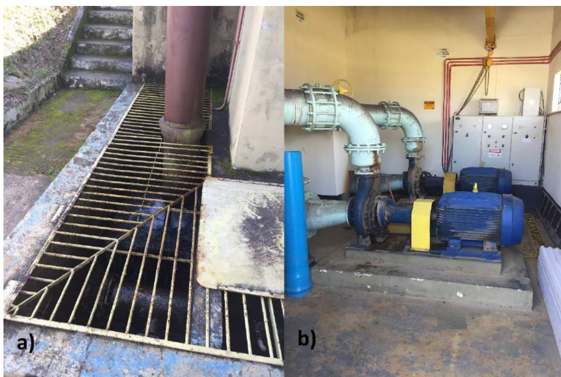
Figura 74 - (a) Poço de sucção; (b) EEAB – Alto Recalque: conjunto motobomba em funcionamento e em reserva
