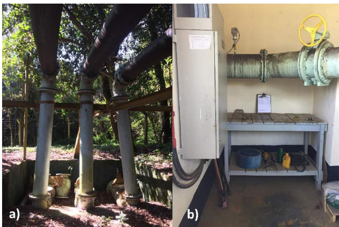
Figura 75 – Tubulações adutoras de água bruta. a) Baixo recalque, b) Início do alto recalque
