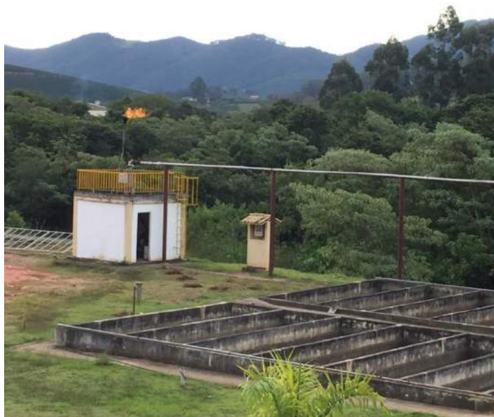
Figura 106 – Queimador de gases
