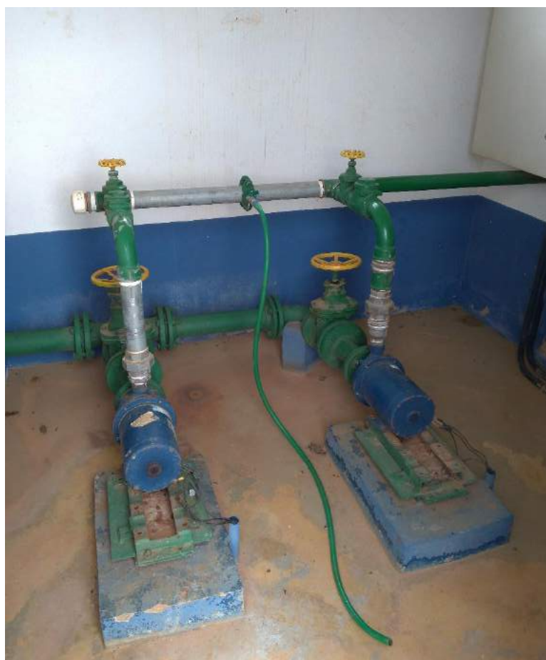
Figura 82 – EEAT-5 Fonte: Próprios autores, 2019
