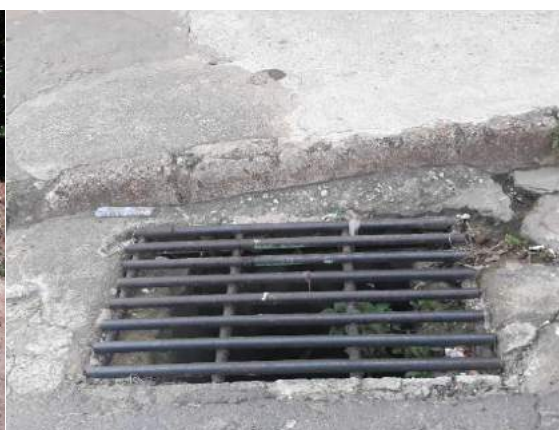
Figura 187 – Boca de lobo
