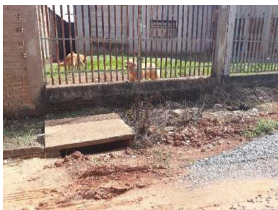
Figura 190 – Boca de lobo
