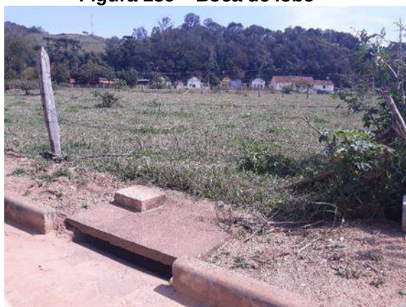
Figura 188 – Boca de lobo
