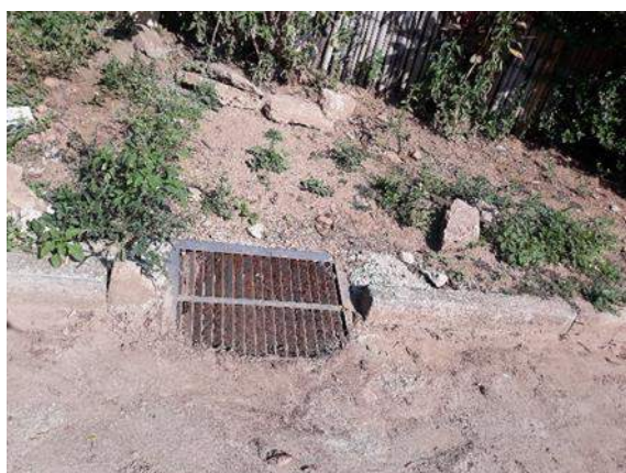
Figura 186 – Boca de lobo
