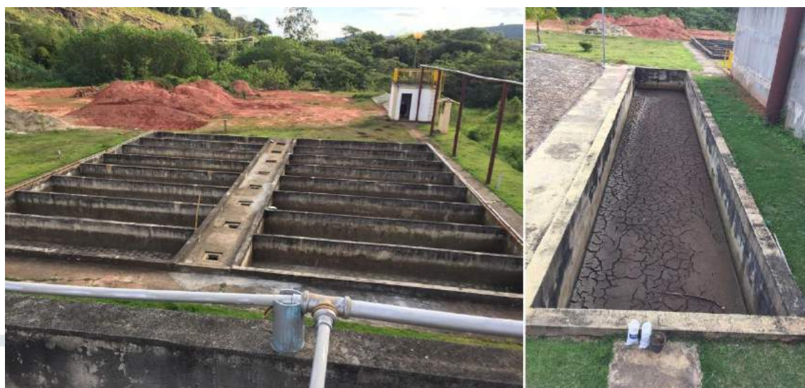
Figura 107 - Leitos de secagem
