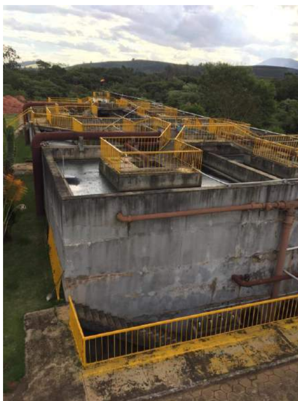
Figura 104 – Câmaras com os reatores UASB
