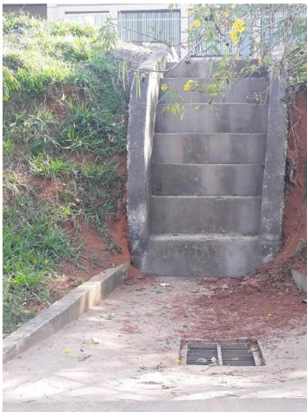
Figura 196 – Escada de dissipação na entrada da Nova Cidade
