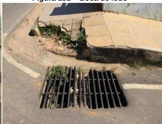
Figura 193 – Boca de lobo
