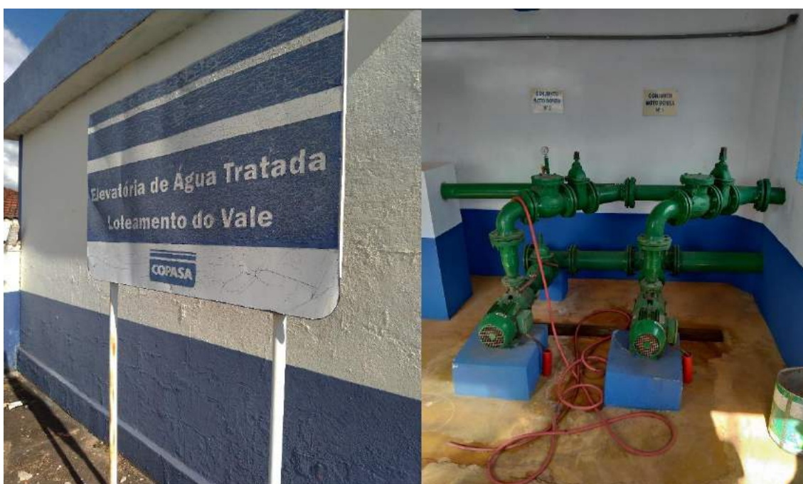
Figura 81 – EEAT-4 Fonte: Próprios autores, 2019
