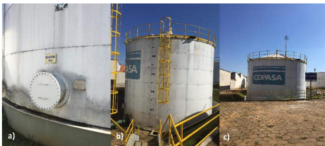
Figura 86 – Reservatórios da ETA Santo Antônio. a) R5, b) R7, c) R8 Fonte: Próprios autores, 2019
