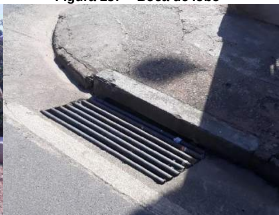
Figura 189 – Boca de lobo
