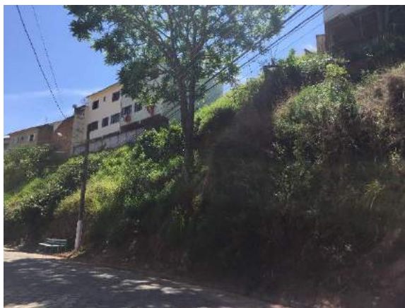
Figura 204 – Área de risco 2 em Santa Rita do Sapucaí
