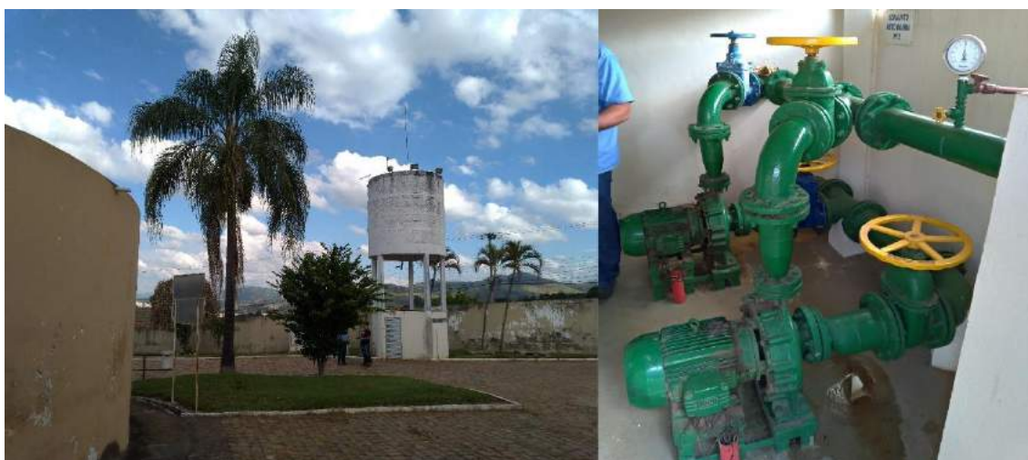
Figura 80 – EEAT-3 Fonte: Próprios autores, 2019
