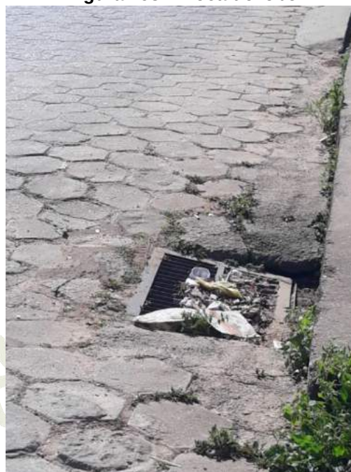
Figura 195 – Boca de lobo
