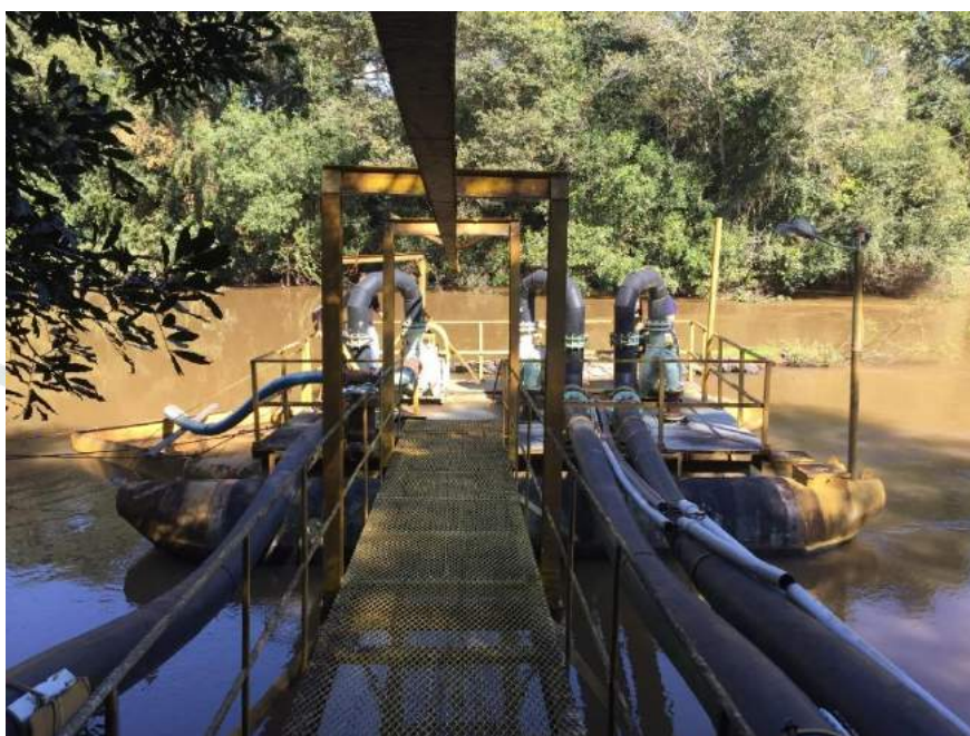
Figura 71 - Sistema de captação: balsa e EEAB - Baixo Recalque Fonte: Próprios autores, 2019
