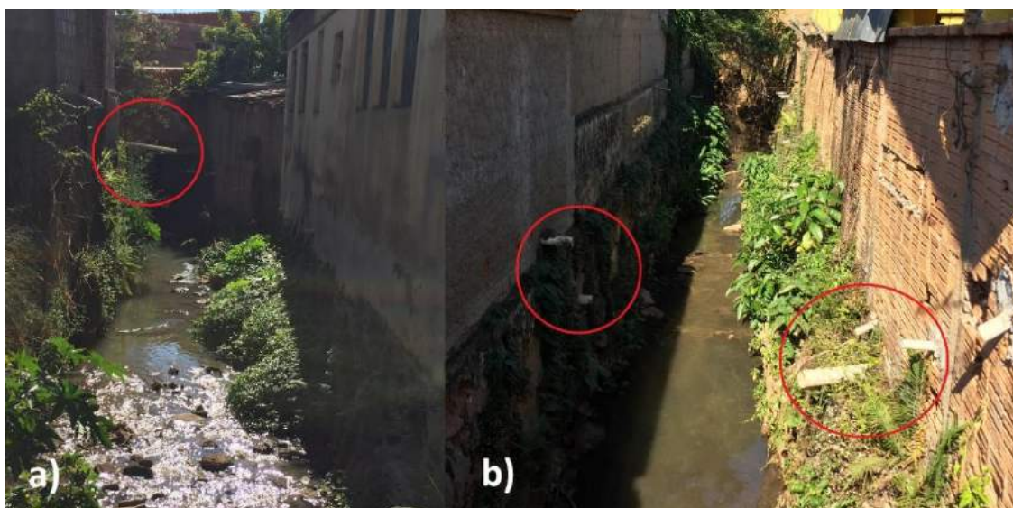
Figura 198 – Ligações clandestinas no Córrego do Mosquito. a) No ponto da “Canalização 3”; b) No ponto da “Canalização 2”
