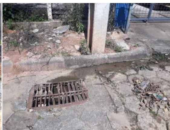
Figura 191 – Boca de lobo
