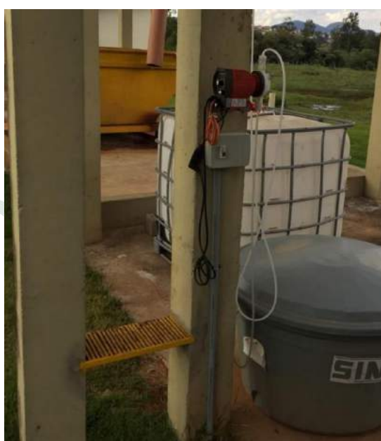
Figura 109 – Reservatório de H_2O_2 e sistema de bombeamento até o desarenador
